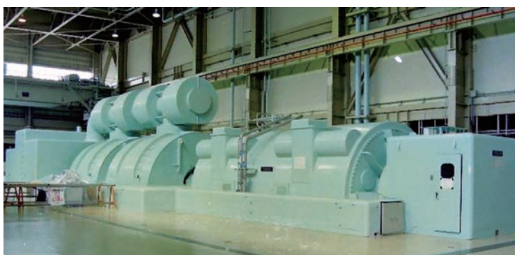
タービン発電機 (タービン建物)
